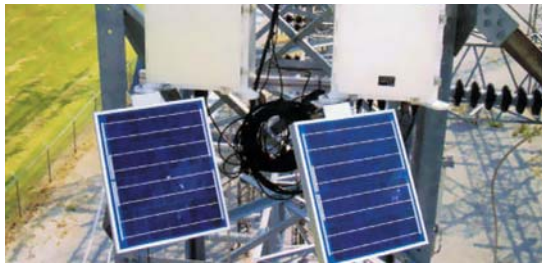
РИС. 5. ▲ Модуль питания CAT-1. Измерительный модуль CAT-1 монтируется на опоре
