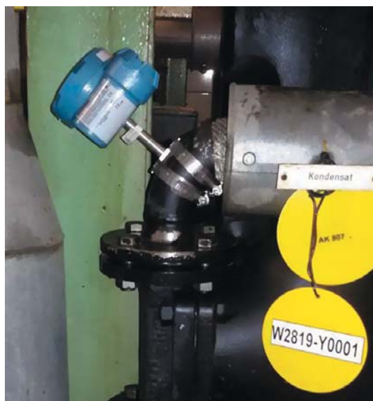
РИС. 3. ▼ Беспроводные акустические преобразователи Rosemount 708 установлены в трех помещениях завода компании Saltigo. Эти преобразователи были установлены на трубах около конденсатоотводчиков
