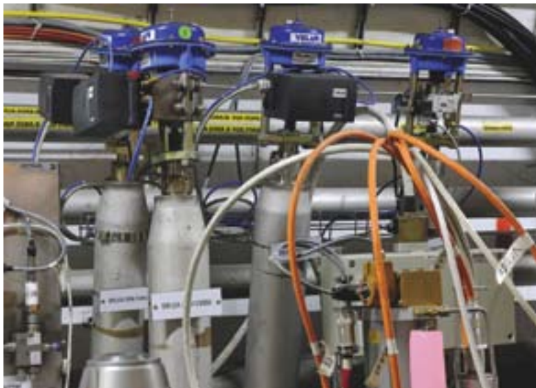
Активные компоненты электроники электро-пневматического устройства позиционирования Sipart PS2 для подачи гелия к криогенным магнитам расположены в шкафах в 1 000 метрах от туннеля БАК.
