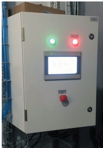
РИС. 3. ▶ Шкаф управления скважинным насосом с сенсорным пультом
