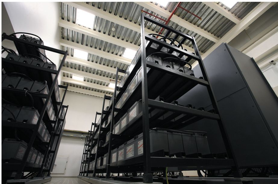
РИС. 1. ▲ Рабочие помещения дата-центра «ТрастИнфо»
