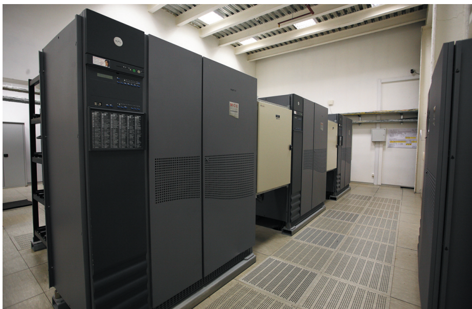
РИС. 2. ▼ Оборудование дата-центра «ТрастИнфо»
