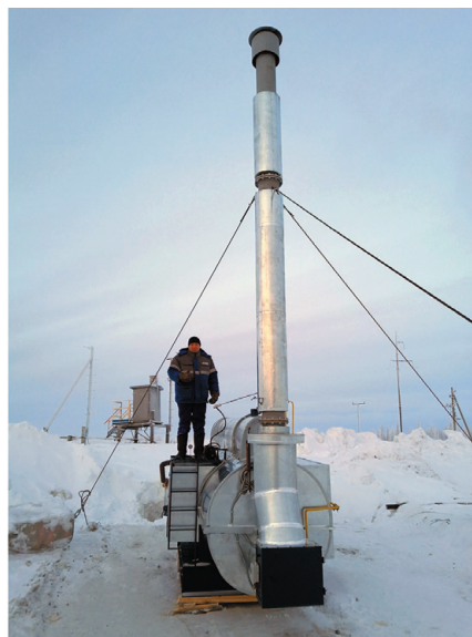
РИС. 3. ◀ Термоэлектрический генератор в сборе и на подогревателе газа ПГ-10
