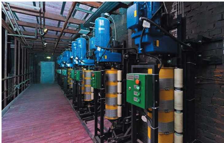
РИС. 1. ▶ Лебедки штанговые. На лебедках установлены кнопочные пульты местного управления от Schneider Electric
