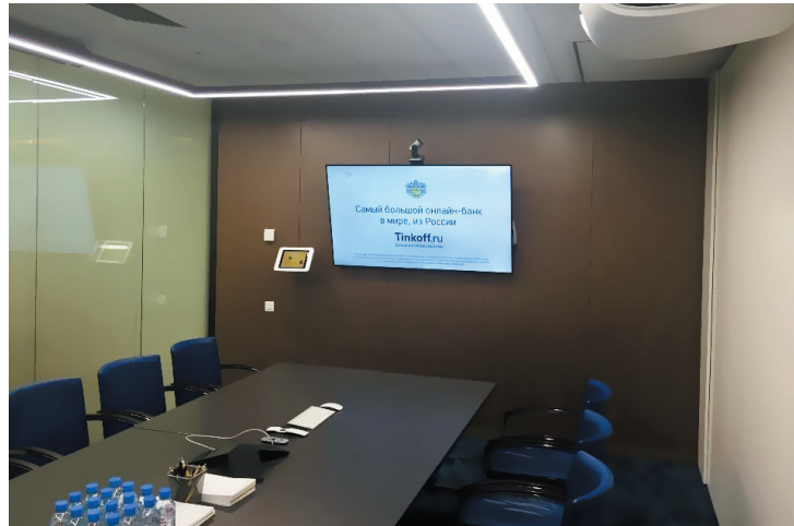
РИС. 5. ◀ Видеокмутатор направляет видеопотоки с нужных устройств на правильные экраны
