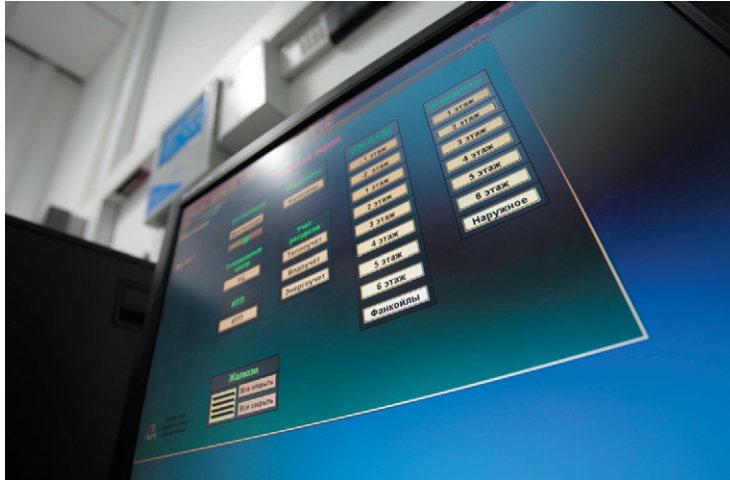
РИС. 3. ► Комплексная система управления зданием Desigo от Siemens
