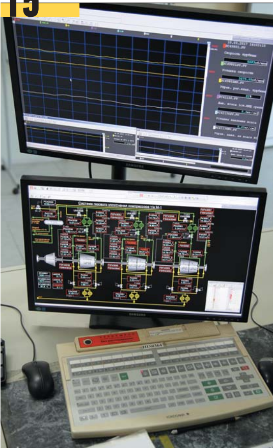
SCADA обеспечена компанией YOKOGAWA, оборудование которой в основном установлено на предприятии.
