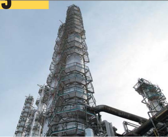
Установка газоразделения. Колонное оборудование.
