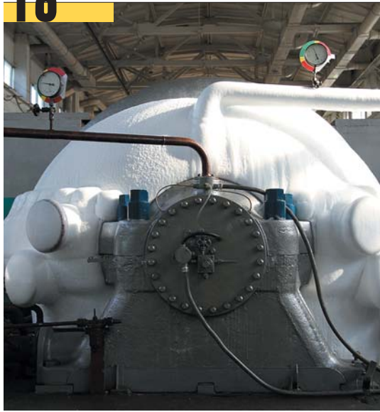
Пропиленовый компрессор турбоагрегата М-6.
