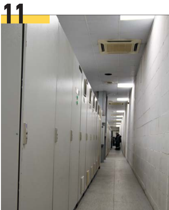
Помещение, в котором находятся шкафы АСУ ТП установки газоразделения.
