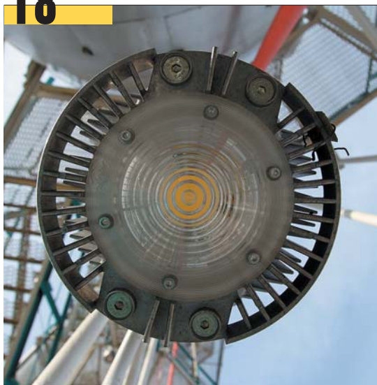
Взрывозащищенный светильник на колонне установки газораспределения.
