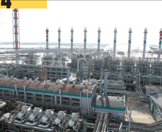
Вид с верха колонны на внутренний периметр производственной площадки. Чуть дальше расположены печи пиролиза.
