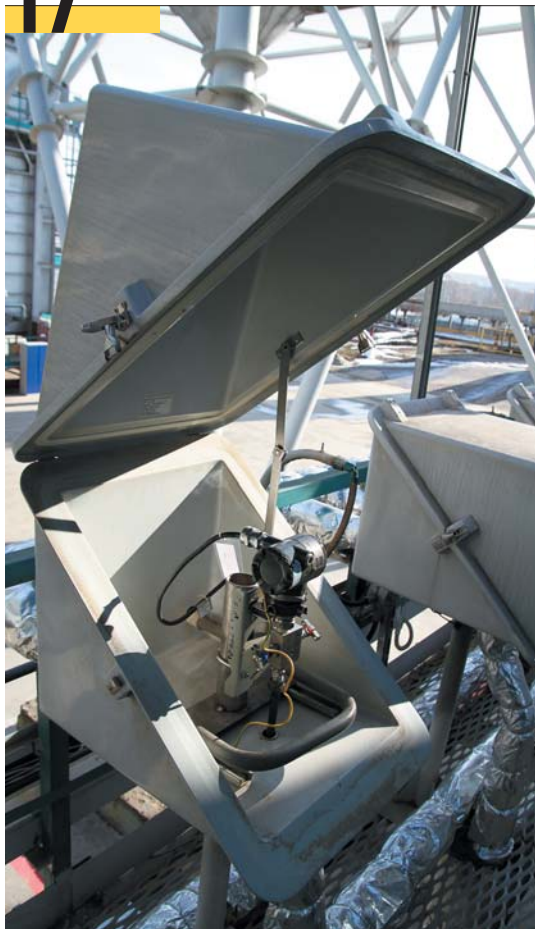
Шкаф КИП с датчиком давления Yokogawa EJA.
