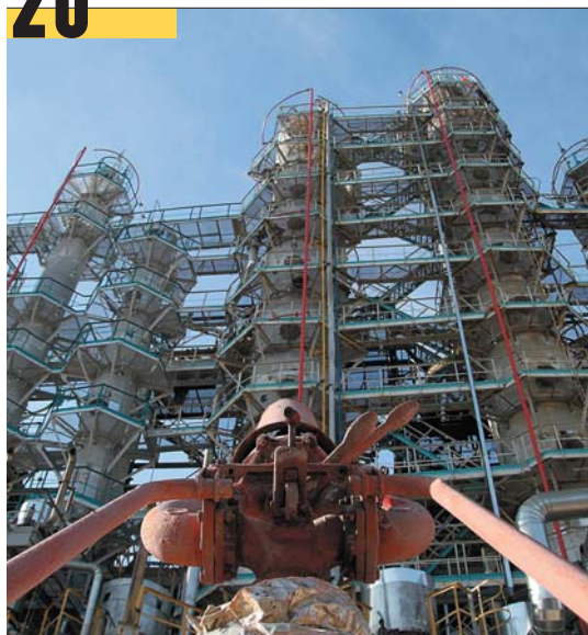
Пожарные гидранты установлены на территории всего завода.
