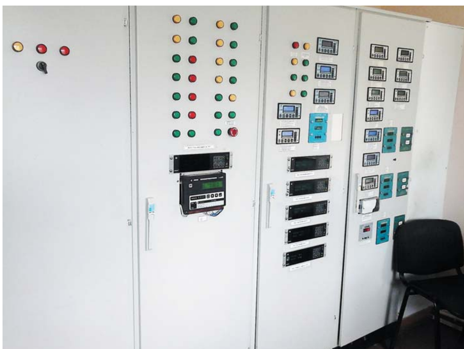
РИС. 3. ▼ АРМ оператора пульта управления ЦДНГ
