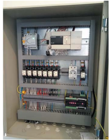
РИС. 2. ▲ Силовой шкаф (а) и станция управления (б)
