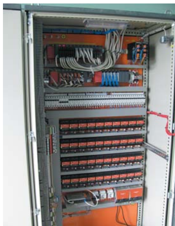
РИС. 3. ► Шкаф системы управления на базе ПЛК SystemQ
