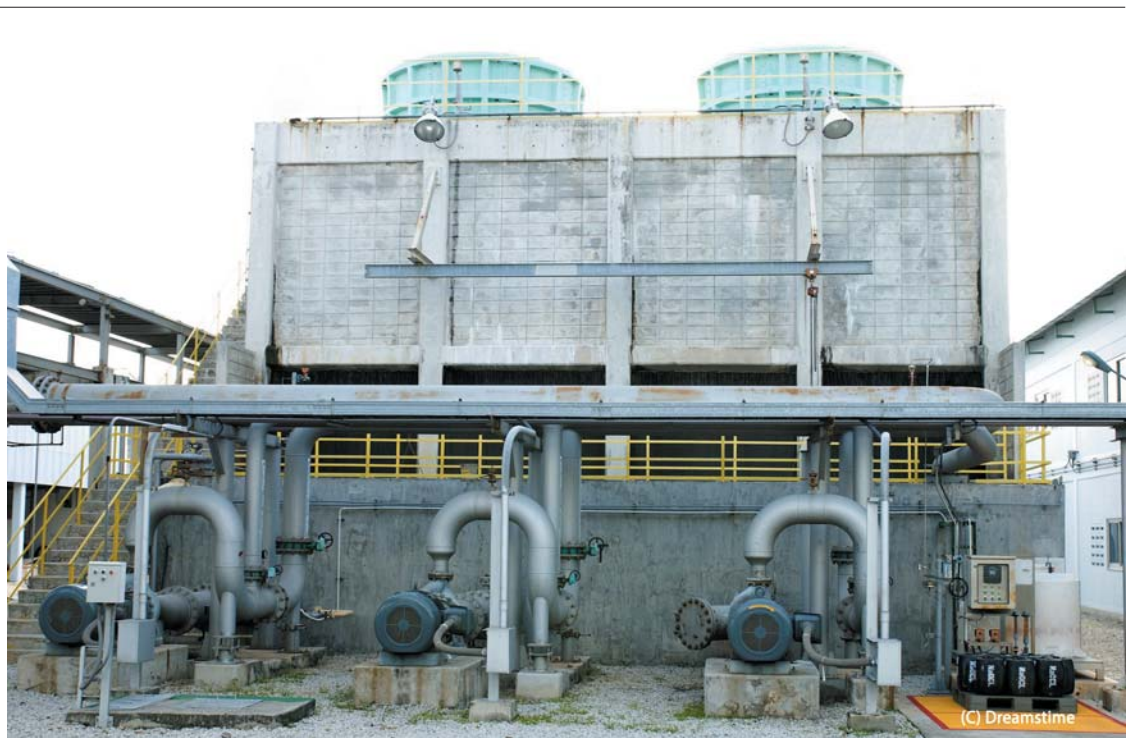
▲ РИС. 3. Вентиляторная градирня
