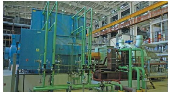
РИС. 4. ▲ Высоковольтный генератор АББ на ПГУ ТЭС «Строгино»
