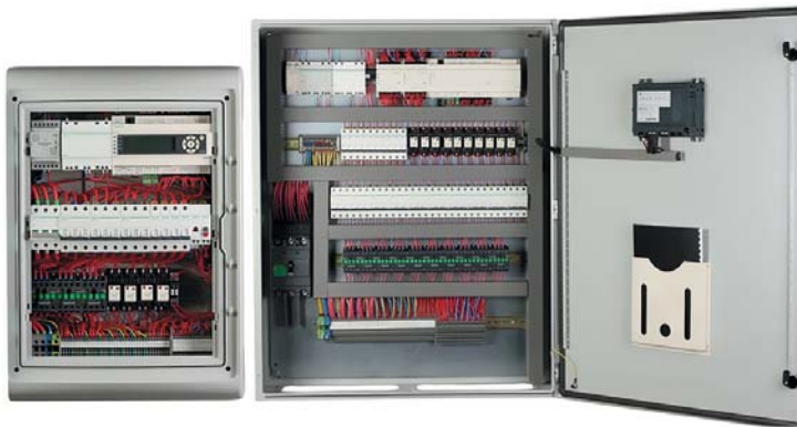
РИС. 3. ▶ Шкафы управления SmartHVAC в открытом виде.
