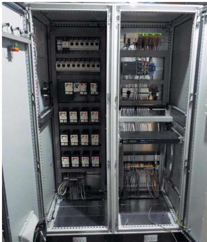
РИС. 3. ◀ Шкаф управления сортировщиком
